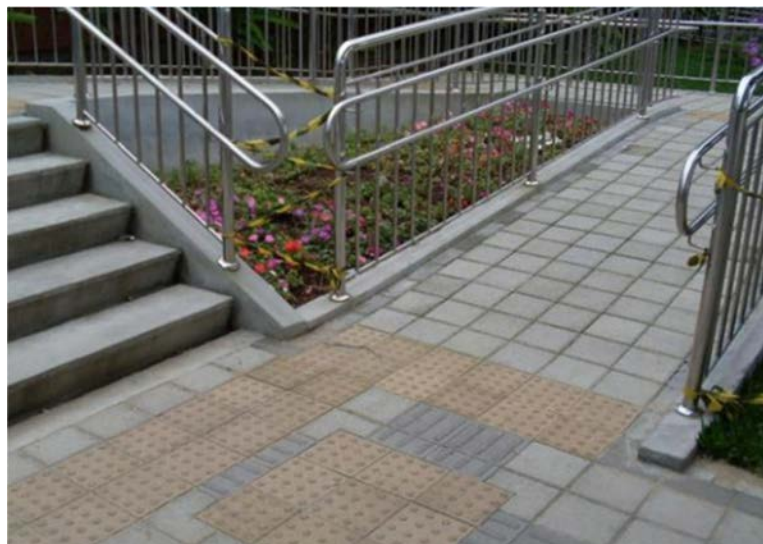
Figura 32 - Instalação de Piso Tátil e Rampa (Proj. Milena Mesquita Galvão, 2010) Fonte: UFSC/DPAE (2016b)
